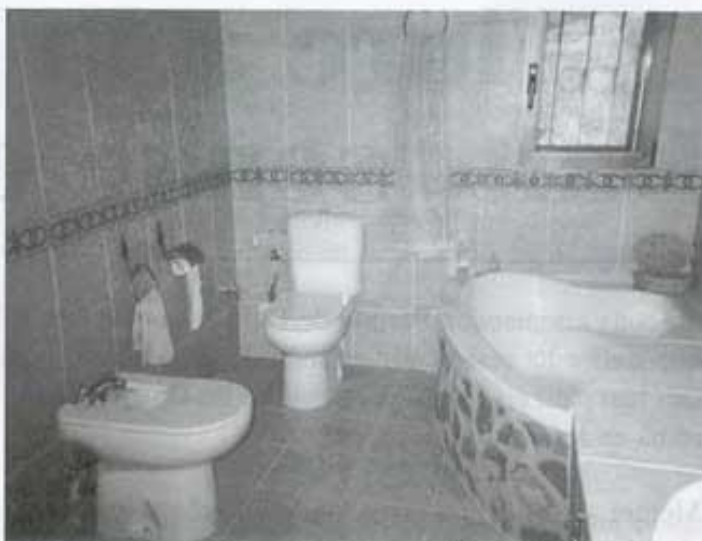
L'aigua potable ha permès fer instal·lacions com les d'aquesta foto. Zona dels Plans.
