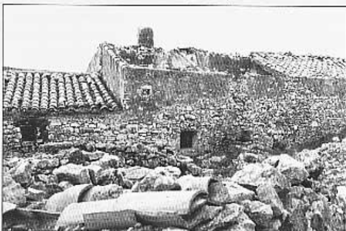
Les teulades ja no aguanten
